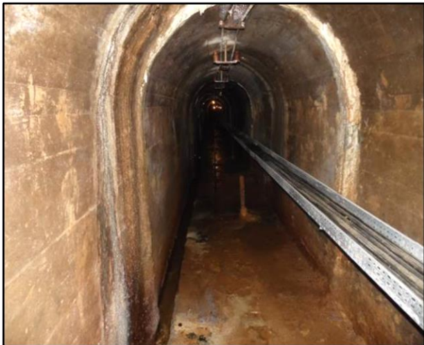
Рисунок 5.4 - Фільтрація води крізь бетон в галереї (потерні) глухої греблі
