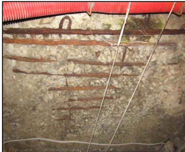
Рисунок 5.5 - Пошкодження захисного шару бетону верху галереї (потерні) водозливної греблі
