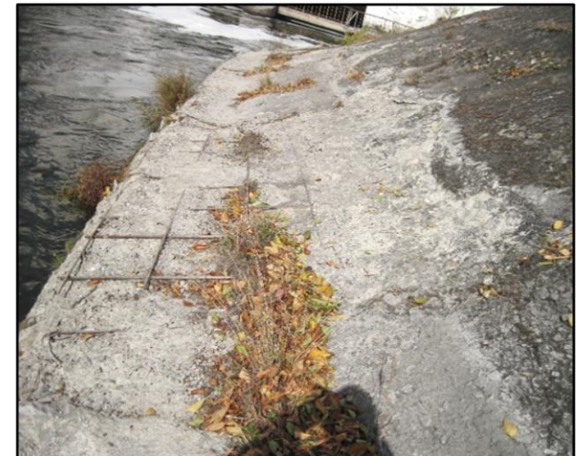
Рисунок 5.6 - Пошкодження захисного шару бетону кріплення укосів відвідного каналу ГЕС
