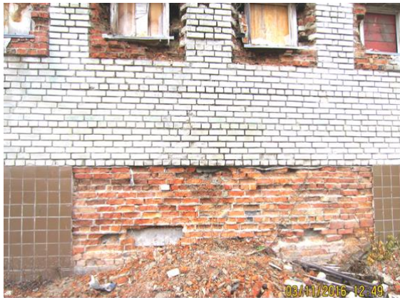
Рисунок П-8-1. Руйнування цегляної кладки огорожувальної конструкції навколо віконних отворів
