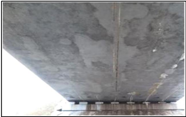
Рисунок II-7-1. Поздовжні тріщини з висолами бетону та сталактитами на нижніх гранях коробчастих балок
