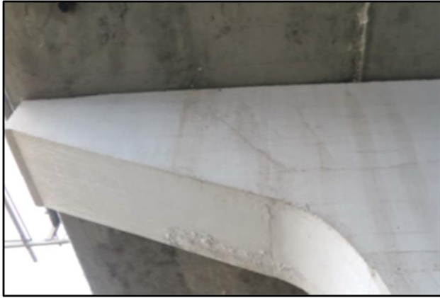
Рисунок П-6-4. Похилі тріщини шириною розкриття до 0,4 мм у консолі ригеля проміжної опори
