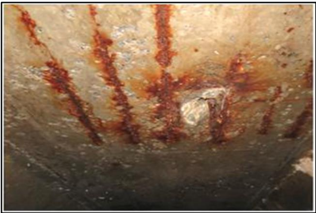
Рисунок II-7-2. Недостатня товщина бетону захисного шару внутрішньої стельової поверхні коробчастої балки з оголенням і корозією поздовжньої арматури
