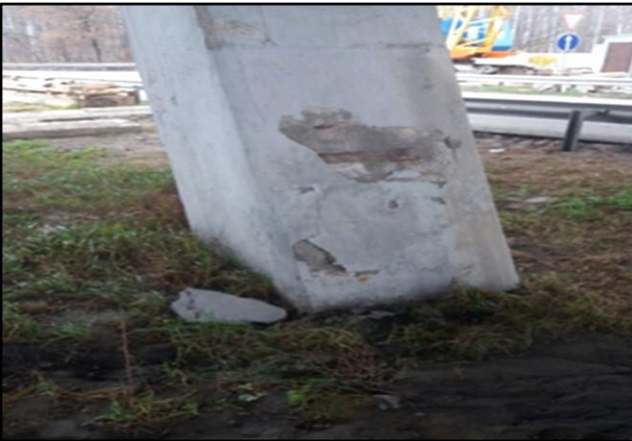
Рисунок II-6-2. Лущення бетону захисного шару стояка опори з оголенням і корозією арматури
