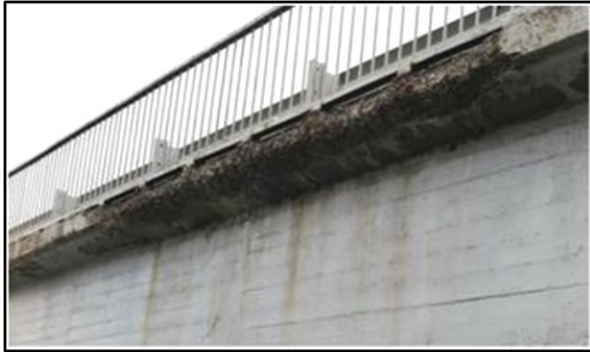
Рисунок П-4-1. Руйнування бетону захисного шару торця та нижньої грані плити тротуарної консолі з оголенням і корозією арматури
