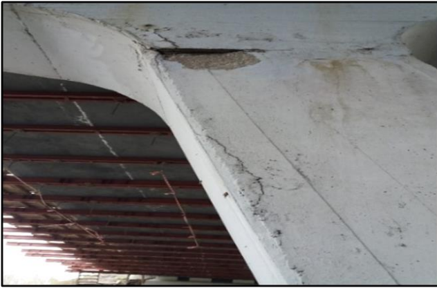
Рисунок II-6-1. Локальні руйнування бетону захисного шару стояка проміжної опори, вертикальна тріщина сколу бетону захисного шару
