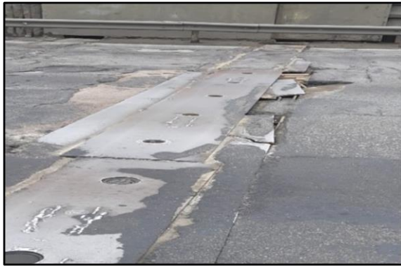
Рисунок П-3-1. Порушення водонепроникних властивостей деформаційного шва проїзної частини
