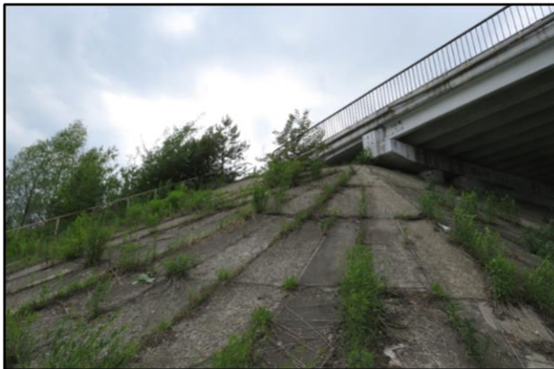
Рисунок П-5-2. Руйнування бетону лицьової поверхні укріплення конуса, проростання рослинності у швах
