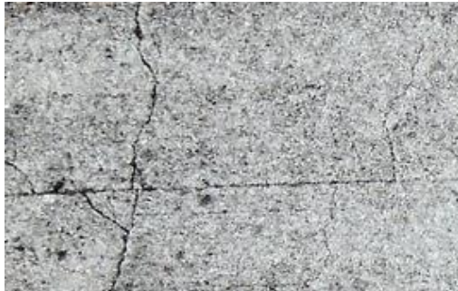
Рисунок П-9-1. Статична тріщина в залізобетонній конструкції
