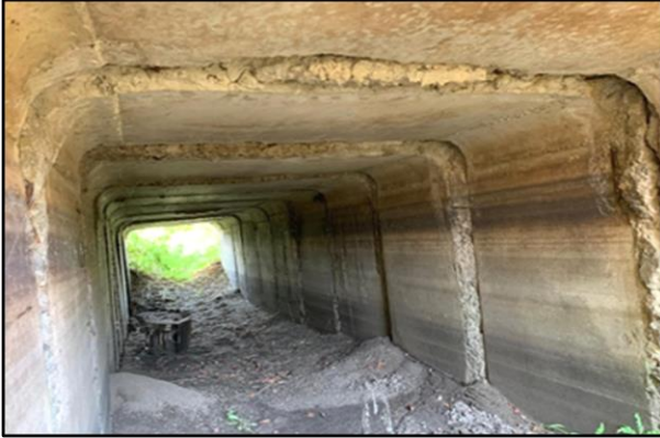
Рисунок IV-3-1. Порушення щільності швів між ланками труби дорожньої
