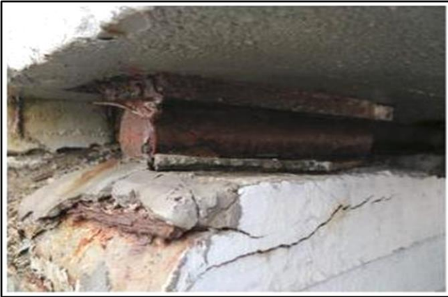
Рисунок П-8-1. Руйнування підферменнику з оголенням і корозією арматури
