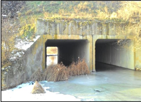
Рисунок IV-4-1. Пошкодження бетону захисного шару оголовка та відкисних крил труби дорожньої
