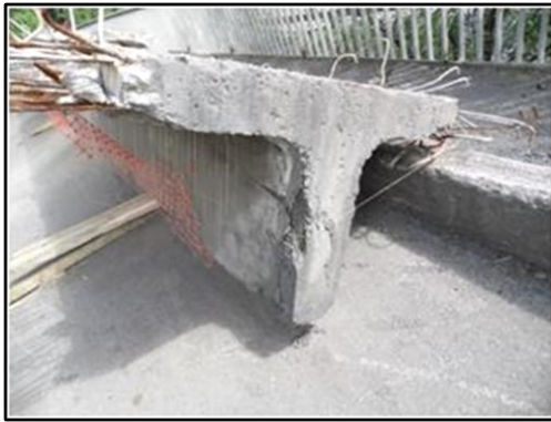
Рисунок III-1-1. Демонтована ребриста балка таврового перерізу, яка рекомендована для відновлення для подальшого повторного використання
