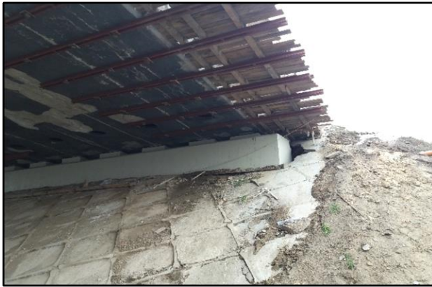
Рисунок П-5-1. Руйнування бетону заповнення бетонної обрешітки укріплення конуса
