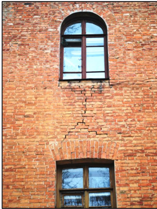
Рисунок II-7-1. Вертикальні тріщини в цегляній кладці огорожувальної конструкції
